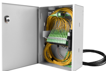
* Przykładowe wyposażenie szafki
